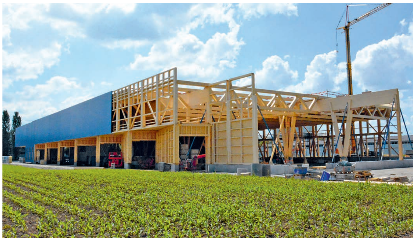
«Mach was mit Holz!» – Beim Bau der neuen Lagerhalle und des Bürotrakts setzte George Kuratle seinen Firmenlogan selbst in die Tat um.
