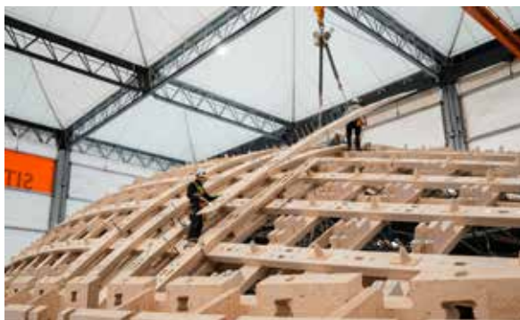
Aus jeweils fünf bis sieben ab Werk gebündelten LVL-Paketen entstand auf der Baustelle ein Balkenträger
