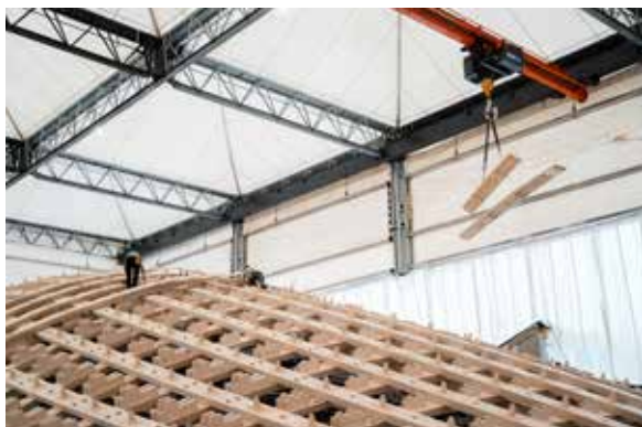
Vor dem Zusammenfügen wurden die Balkensegmente in Form gebogen und dann zu Trägern montiert
