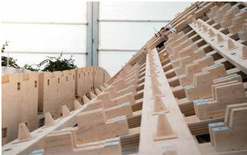
Alle Verbindungen des Dachtragwerks wurden mit Dübeln und Zapfenverbindungen aus LVL-Furnierschichtholz erstellt Fotos: Blumer Lehmann
